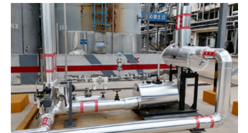
全厂蒸汽疏水阀管理系统
