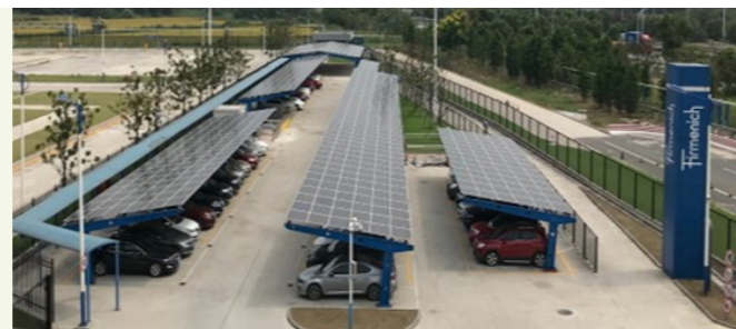
太阳能光伏板
